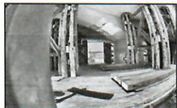
Ein Blick unter die abgestützte Hochstraße Süd in Ludwigshafen. Foto: Gerold
