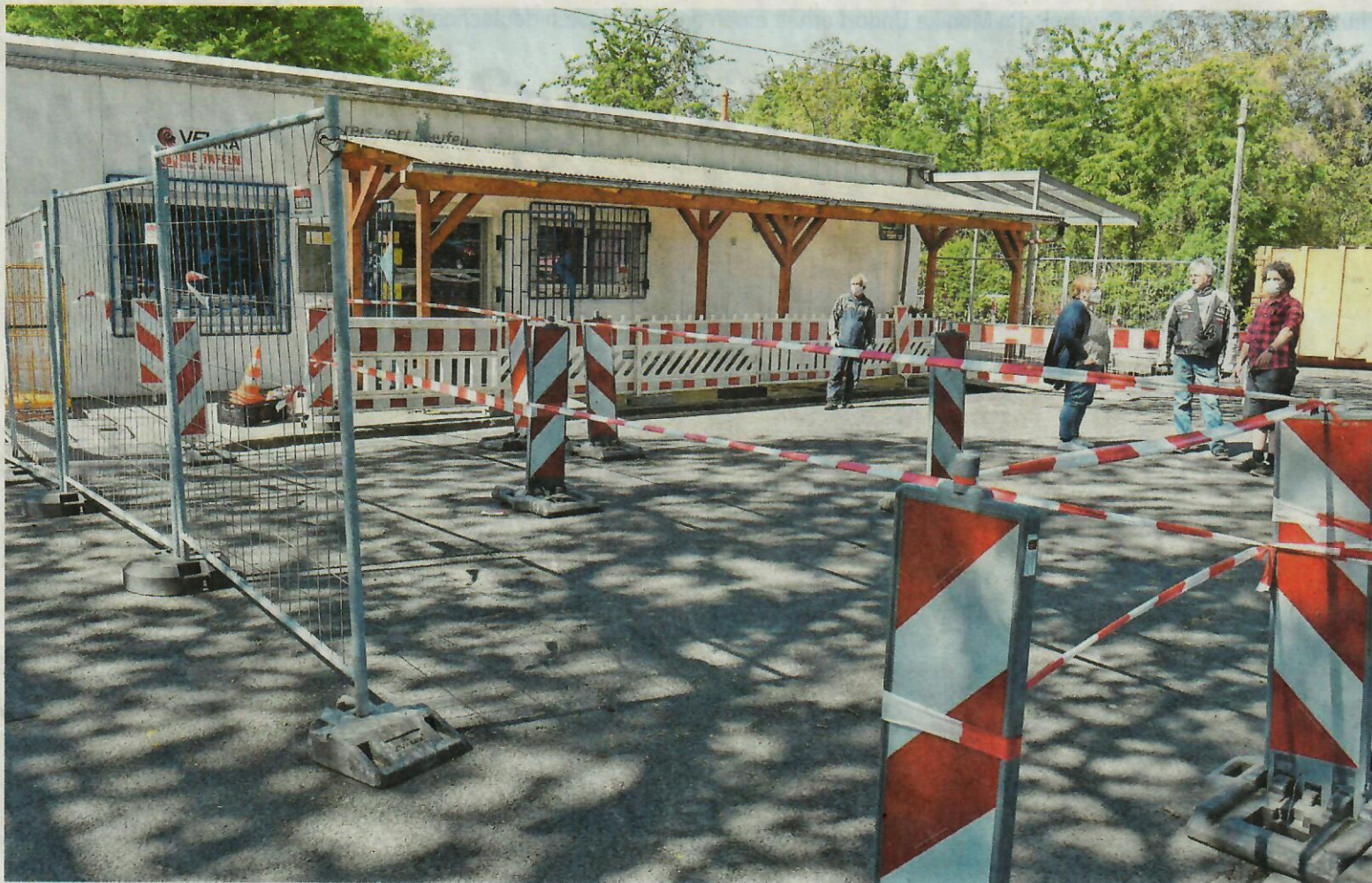
Mit dieser Konstruktion aus Warnbaken, Baustellenzäunen und Absperrband werden die Kunden zur Ausgabestelle geleitet.
